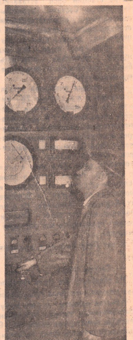
И. Ф. Малышев у приборов автоматизации управления котлом.
